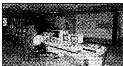
【函館指令センターの列車制御装置】
