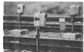
障害物検知装置
