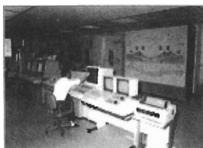
【函館指令センターの列車制御装置】
