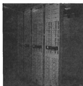
【ATC装置ユニット】
