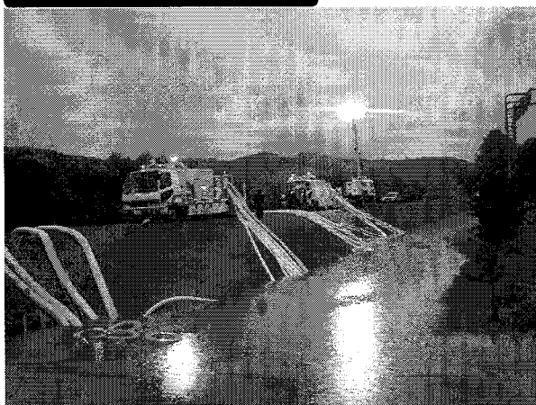
災害時の排水状況
