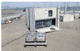
電気設備の被害 (神戸港)
