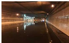
トンネルの冠水状況 (神戸港)
