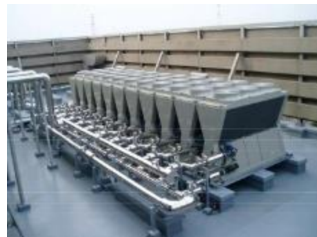
空調用ヒートポンプチラー
