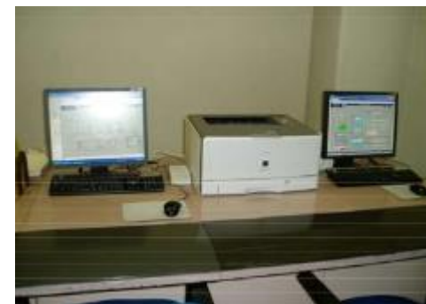
中央監視設備改修と機能向上による省力化
