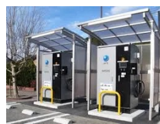
EVバスの 充電施設
