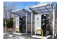
蓄電池・充電施設
